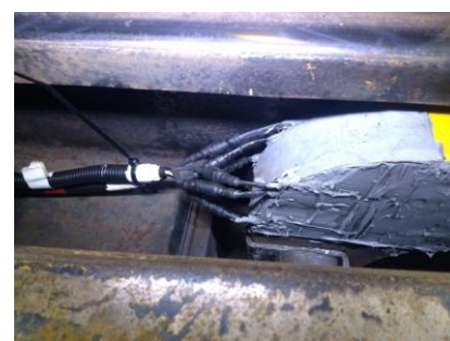
クロッシングの先端部の状況
