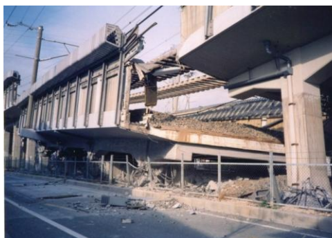
図1 高架橋の被災例
