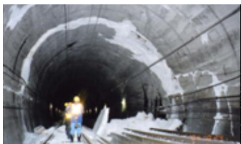
図 11 山岳トンネルの被災例
