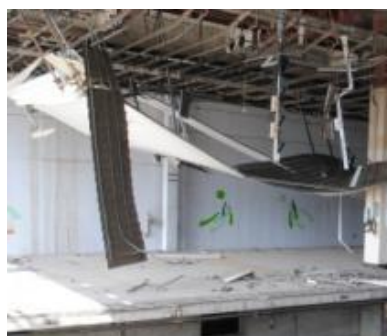
図 15 駅施設の被災例
