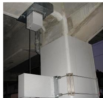
図3 高架橋柱損傷検知装置
