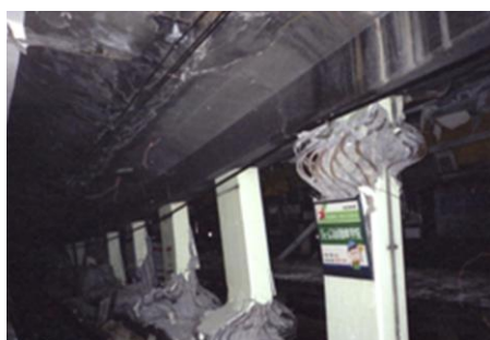
図 13 開削トンネルの被災例
