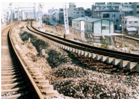
図9 盛土の被災例
