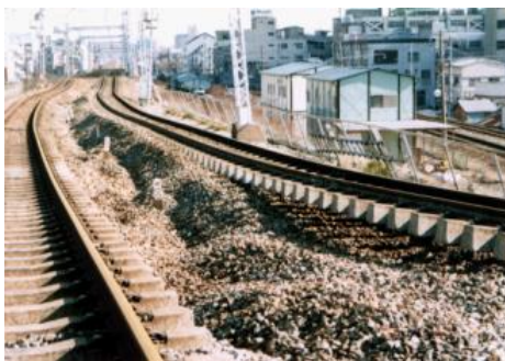
図9 盛土の被災例
