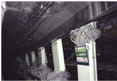
図 13 開削トンネルの被災例
