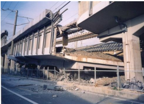
図1 高架橋の被災例
