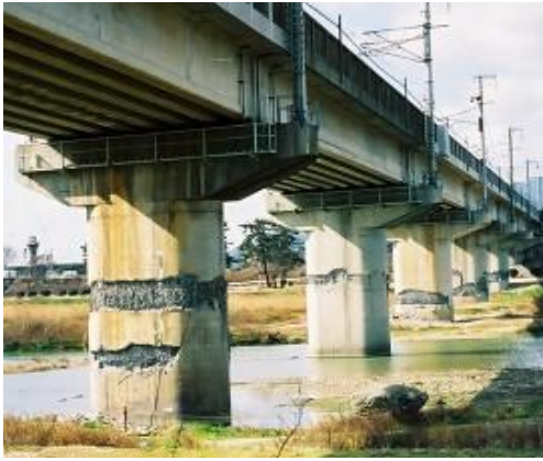
図6 橋脚の被災例
