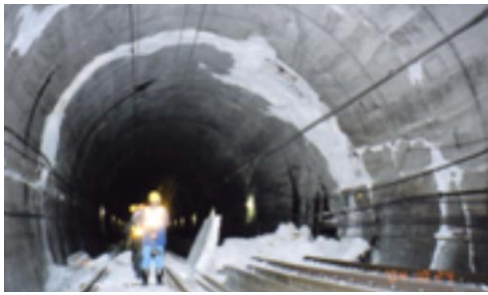
図 11 山岳トンネルの被災例
