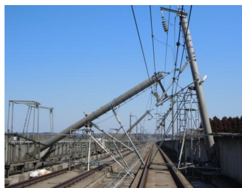
図3 東北地方太平洋沖地震による電車線柱の損傷
