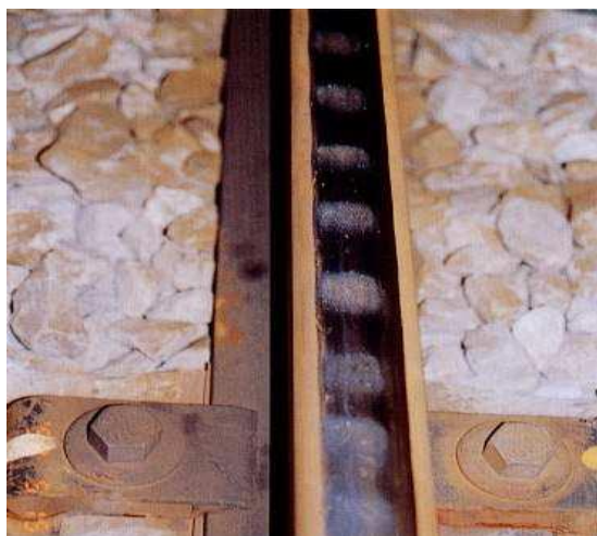
図 1 レールの波状摩耗
