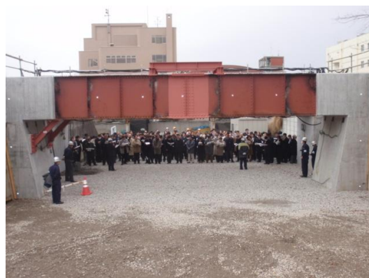
図 4 既設盛土一体化橋梁（補強後） ※平成 23 年 3 月に開催した技術説明会の様子
