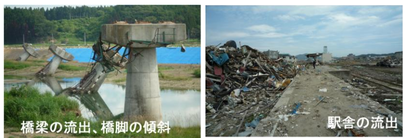
図3 沿岸部の津波被害
