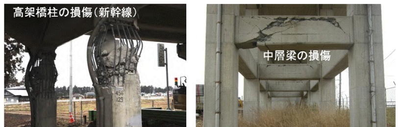
図1 土木構造物の地震動被害(新幹線)
