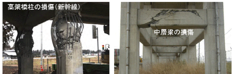
図1 土木構造物の地震動被害(新幹線)
