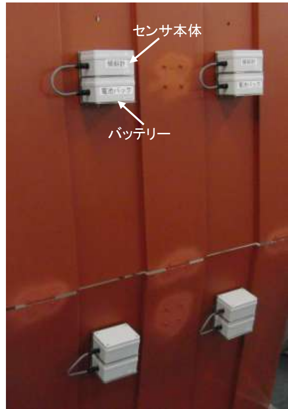
図13 仮土留工常時監視システム (試作)
