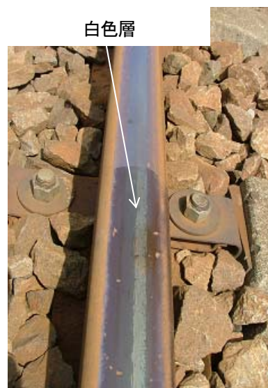
図1 レール頭頂面に発生した白色層
