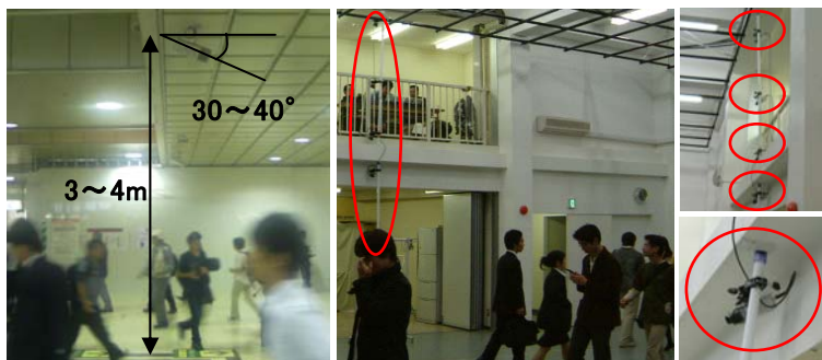
図2 一般的な駅構内の監視カメラ
