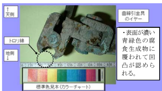
図1 腐食したイヤーの外観
