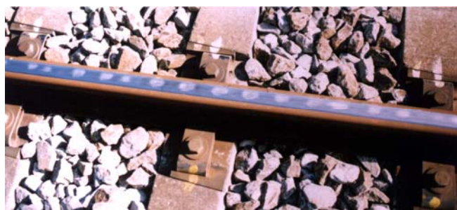
図3 急曲線内軌波状摩耗
