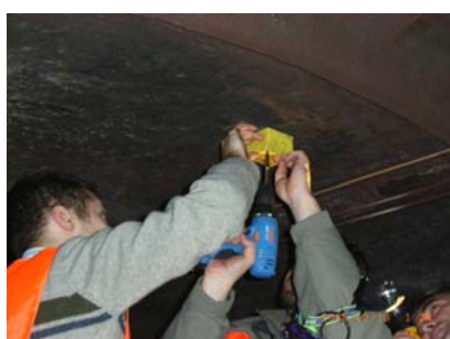
図6 ケースの設置
