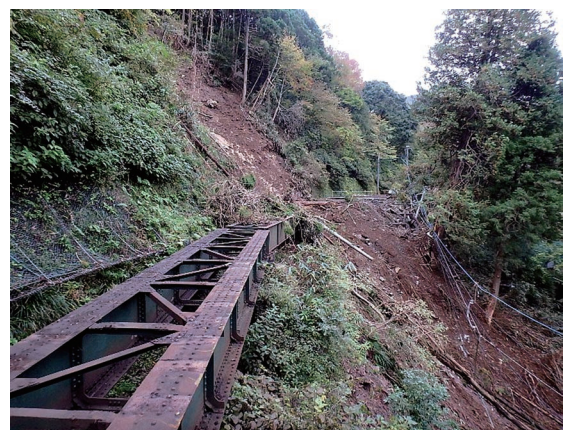
図2 2019年台風19号で被災した箱根登山鉄道
