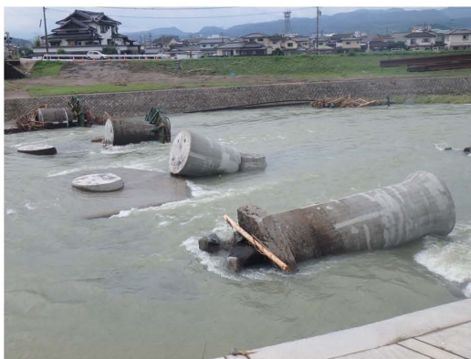
(a) 橋りょうの被災状況
