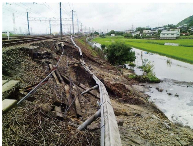
図4 平坦地の盛土の崩壊
