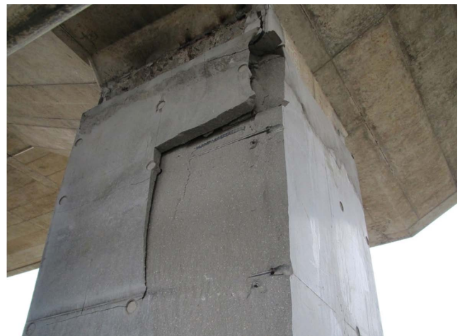
図1 東北地方太平洋沖地震の余震による被害例 (RCラーメン高架橋柱)
