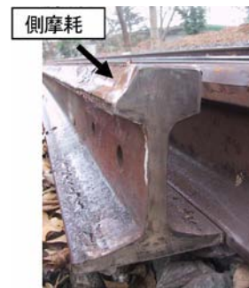
図2 レールの摩耗例（側摩耗）
