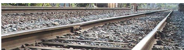
図1 軌道変位の例（レール継目部の高低変位）
