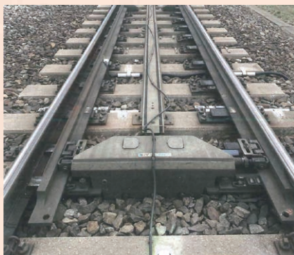
トングレールに取り付けられた vaSIG の測定センサー「zentrak IM」 《出典 Eisenbahntechnische Rundschau》
