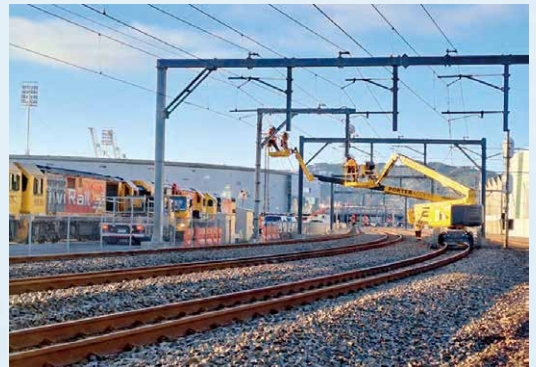
駅進入路の門形支持物に新しい信号機を取り付ける作業員たち 《出典 Railway Gazette International》
