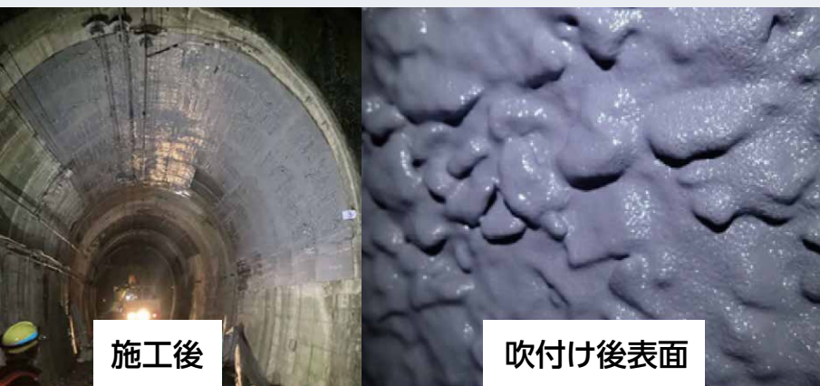
図14 骨材が露出した場所打ちコンクリート造のトンネルでの施工例 3)
