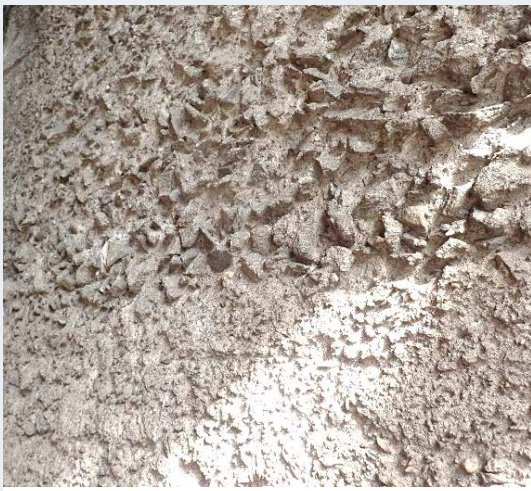
骨材の露出の例
