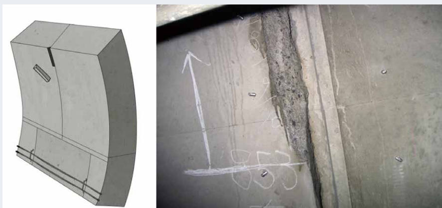
図3 トンネルからの小規模なはく落 1)
