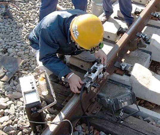
図6 レール頭部の側面からの手探傷
