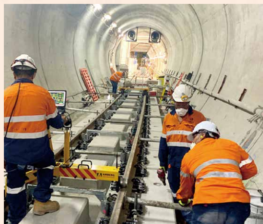
Woolloongabba ではさらに振動を低減して近隣建造物への影響を最小化するため、フローティングスラブ軌道が採用された。
