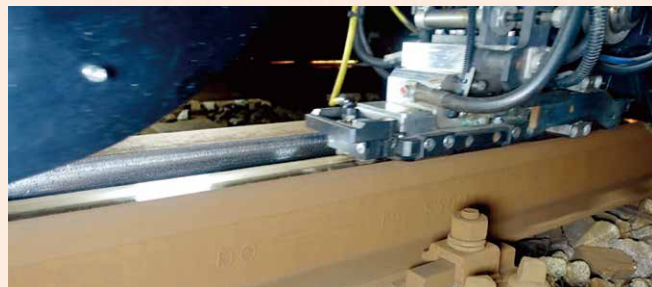
ウィーンプロジェクトでは 400 UHC HSH レールの採用と MG11 によるミリングの組み合わせで、路線の運用効率が向上し、メンテナンスのライフサイクルコストが最適化されることが示された。
