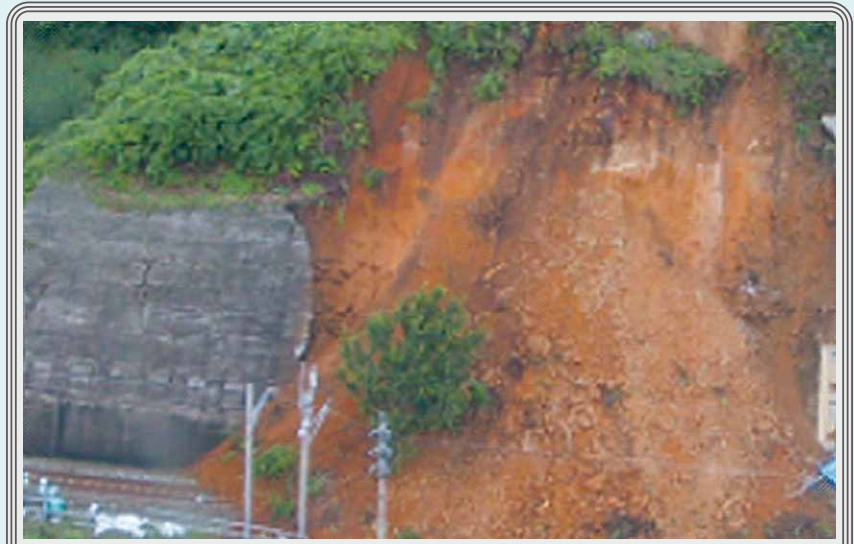
参考図 のり面工の倒壊事例
