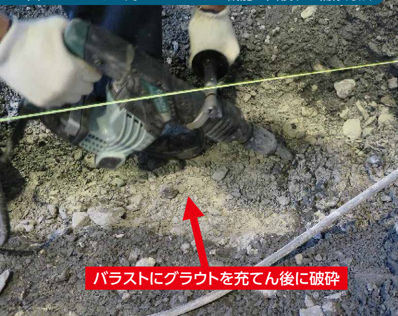
図2 グラウトを用いてバラストの機能を回復する補修方法
