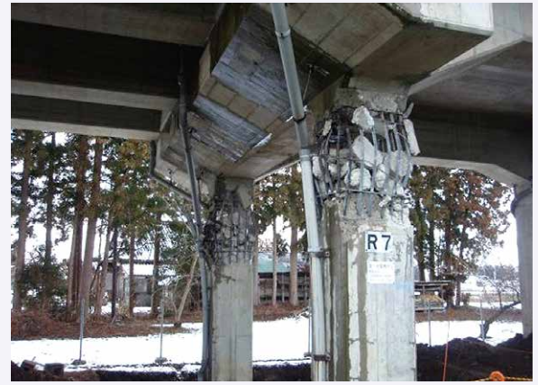
図3 東北地方太平洋沖地震でのラーメン高架橋の被害事例 3)
