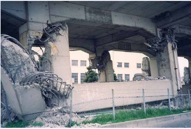
図2 兵庫県南部地震でのラーメン高架橋の被害事例 2)
