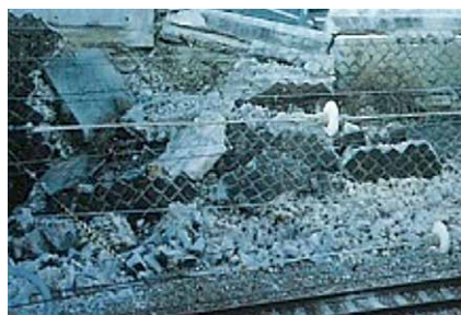
図1 擁壁の被害事例 (兵庫県南部地震) 1)
