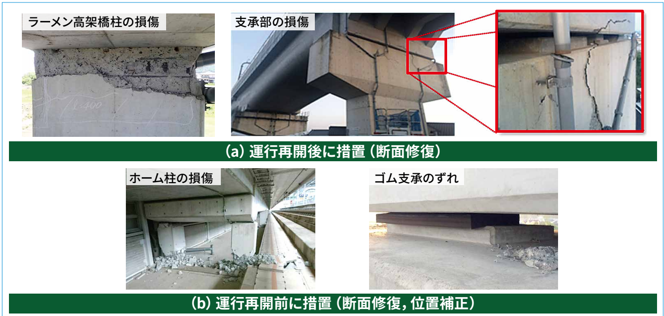
図5 熊本地震により被災した九州新幹線高架橋の診断 10)
