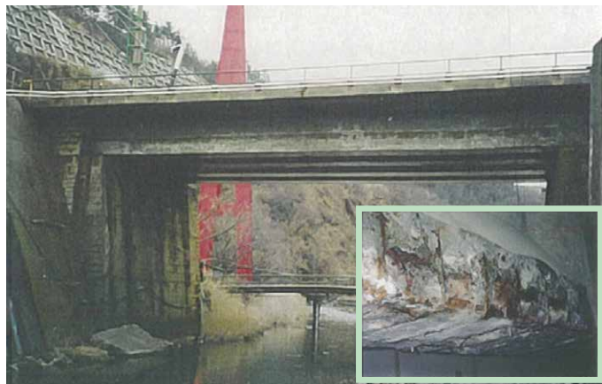
図1 1998年の橋桁全景と鉄筋腐食状況
