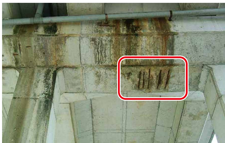
図1 水掛かり箇所での鉄筋露出 2)
