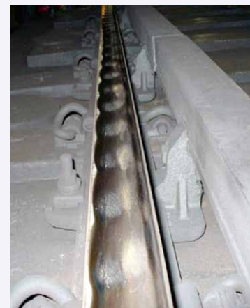
図3 レール波状摩耗の発生状況
