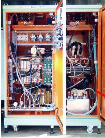
高周波電源装置
