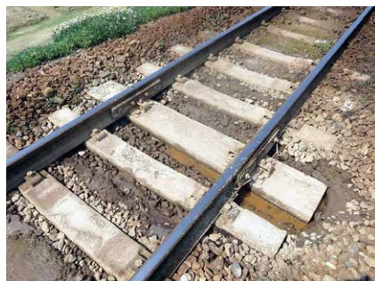
図1 噴泥の生じたバラスト軌道の例
