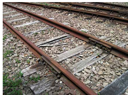
図2 腐食した木まくらぎの例
