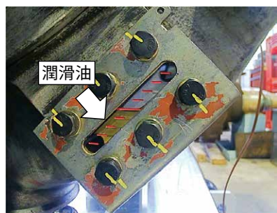
図2 油面計の例(電車歯車装置)
