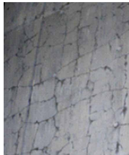
図3 コンクリート構造物のひび割れ事例
