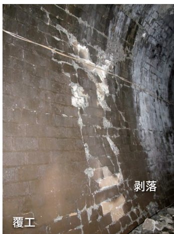
図1 トンネル覆工の被害
