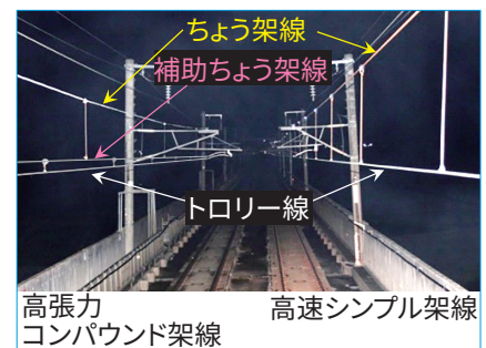
図2 300km/h超運転に対応した高速シンプル架線と高張力コンパウンド架線
