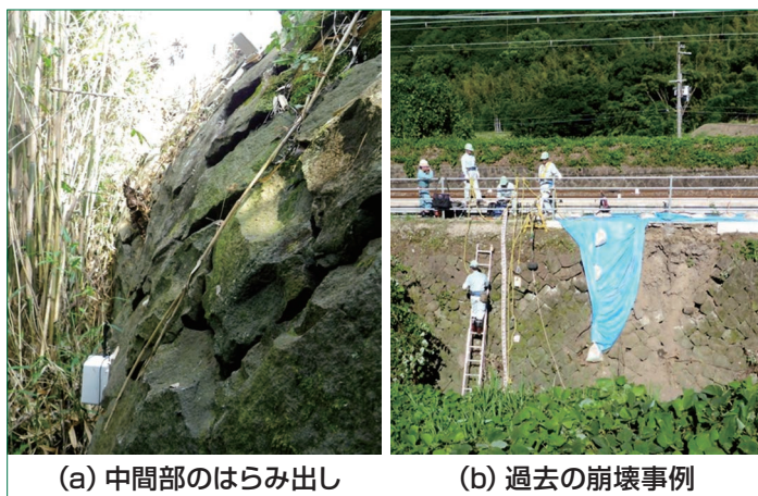
図1 石積み壁に発生した変状
