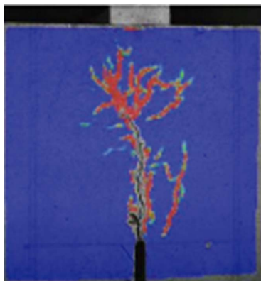
図4 ステレオカメラで検知したコンクリートのクラック (提供：構造計画研究所)
