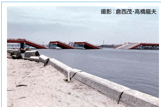
(a)昭和大橋の落橋 1)
