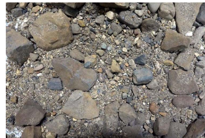
図2 経年による劣化バラストの例
