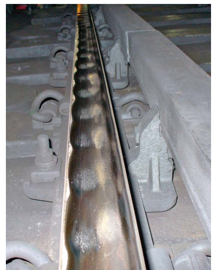
図1 レール波状摩耗の例
