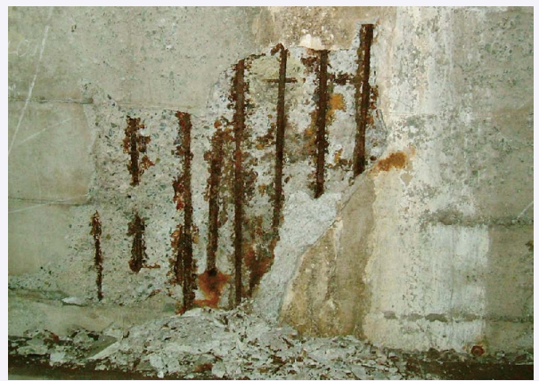
図8 塩害により劣化した建造物の例
