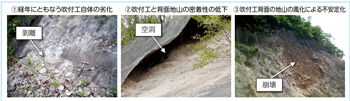
図2 老朽化した吹付工の変状事例
