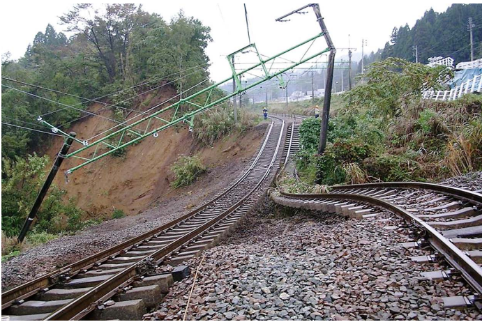
図2 新潟県中越地震における盛土の被災
