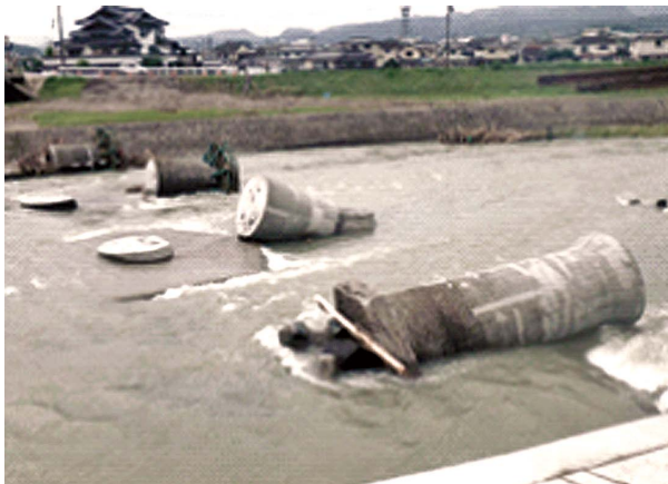
図2 2017年7月九州北部豪雨で被災した橋りょう
