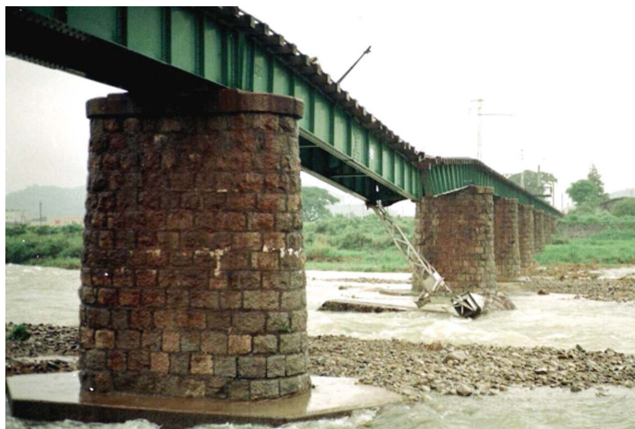
図1 洗掘により橋脚が転倒した事例
