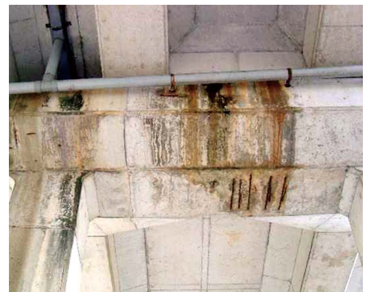
図5 水がかかる箇所での鉄筋の露出 1)
