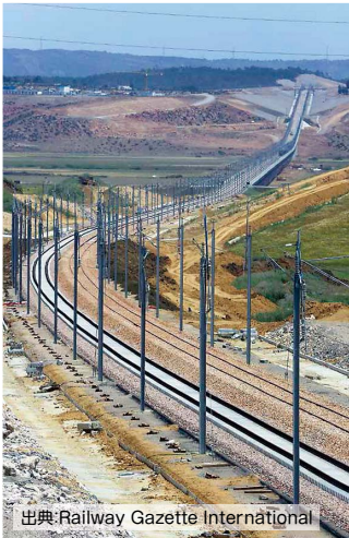
出典:Railway Gazette International タンジェ～ケニトラ間の軌道敷設と電化設備工事
