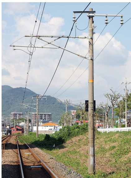
図1 コンクリート電柱建植状況例
